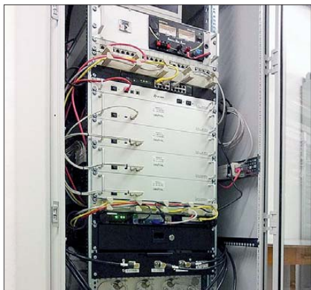
Blick in den DB0ESS-Technikschrank Foto: DB0ESS
